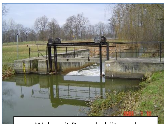
Wehr mit Doppelschütz und Wehrantrieb
