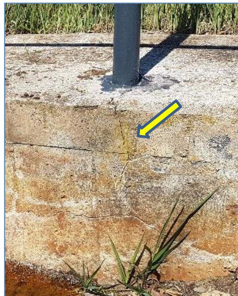
Spannungsriss durch unterschiedliche Ausdehnungen von Beton u. Stahl bei Temperaturveränderungen
