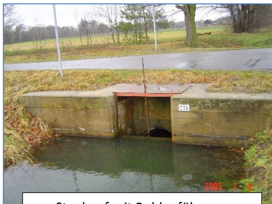
Staukopf mit Bohlenführung, Niederhalter u. Rohrdurchlass
