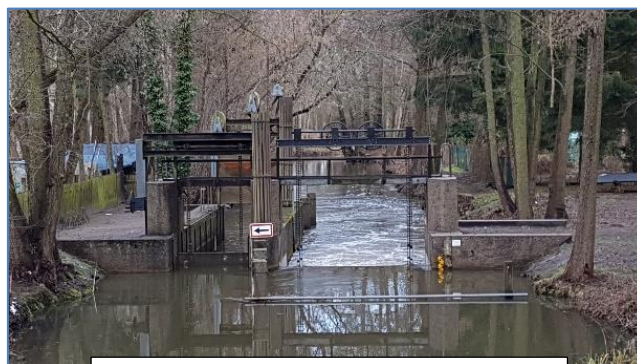
Wehr mit Doppelschütz, Wehrantrieb u. Schleuse
