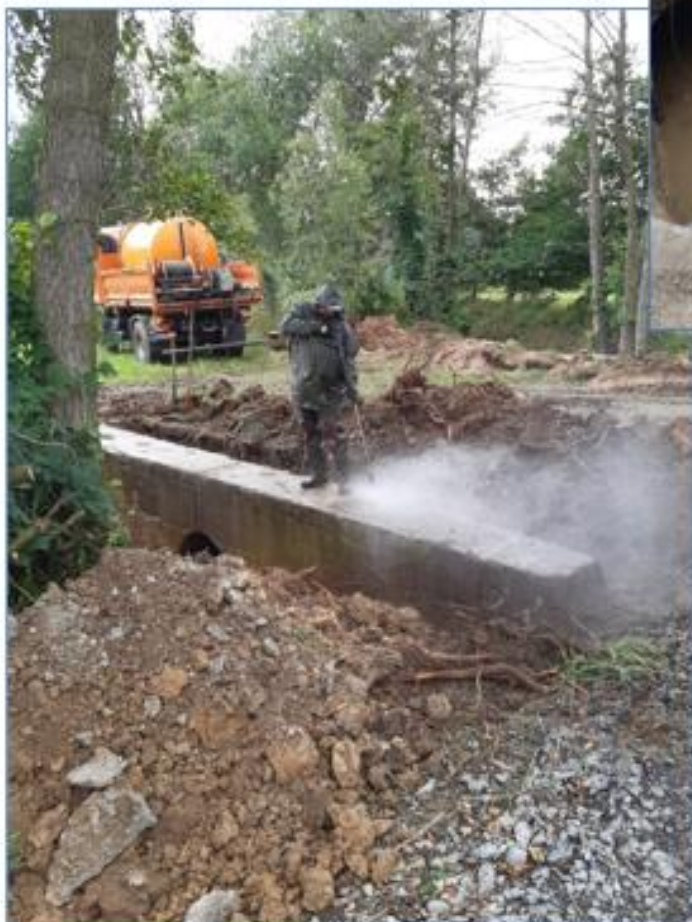
Säubern der Anlage mit Hochdruckreiniger
